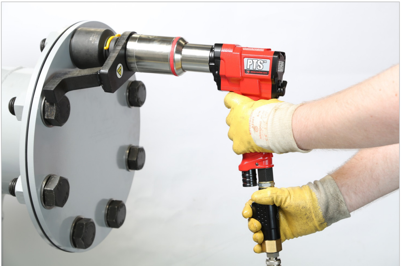
KUVA 10 – PTS, johon on asennettu kaksoisliipaisinmoduuli
